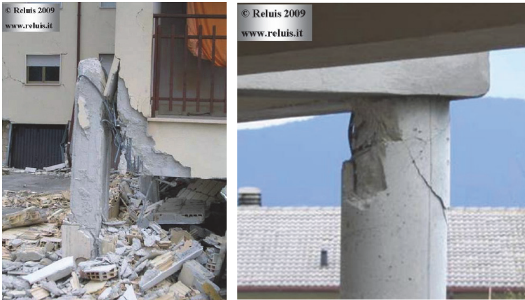
Figura 5.5 Meccanismi di collasso di colonne per edifici in c.a. colpiti dal terremoto dell'Aquila, (fonte Reluis 2009) [45]
