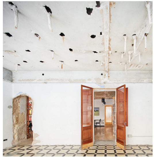
Fig. 5. Manacor, Isola di Maiorca, Can Lliro, Aulets Arquitectes + Carlos Oliver (da SERRAZANETTI 2020).
