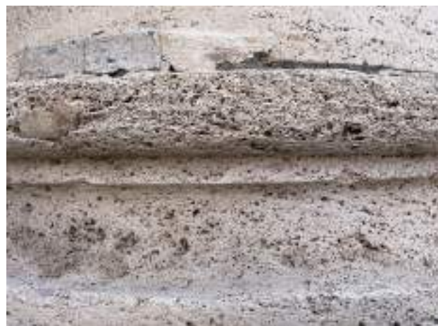
Fig. 5. Napoli, Museo Archeologico Nazionale. Prospetto meridionale, particolare della base della colonna in travertino a destra del portale principale d'accesso. Si riscontra, oltre alla presenza di tassellature, il fenomeno dell'alveolizzazione principalmente nella parte basamentale della colonna (Foto R. Amore 2022)
